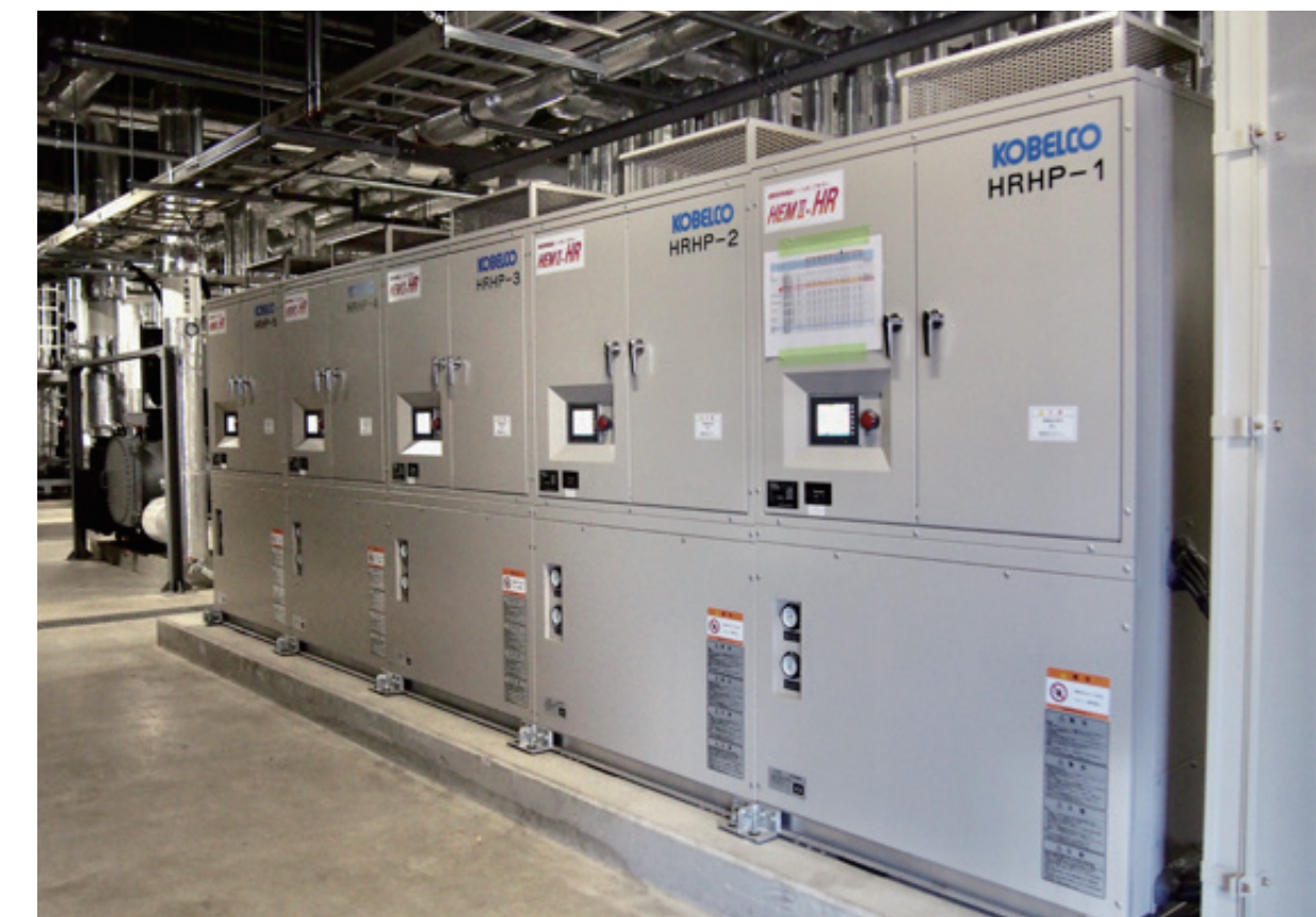
● 熱回収ヒートポンプ
