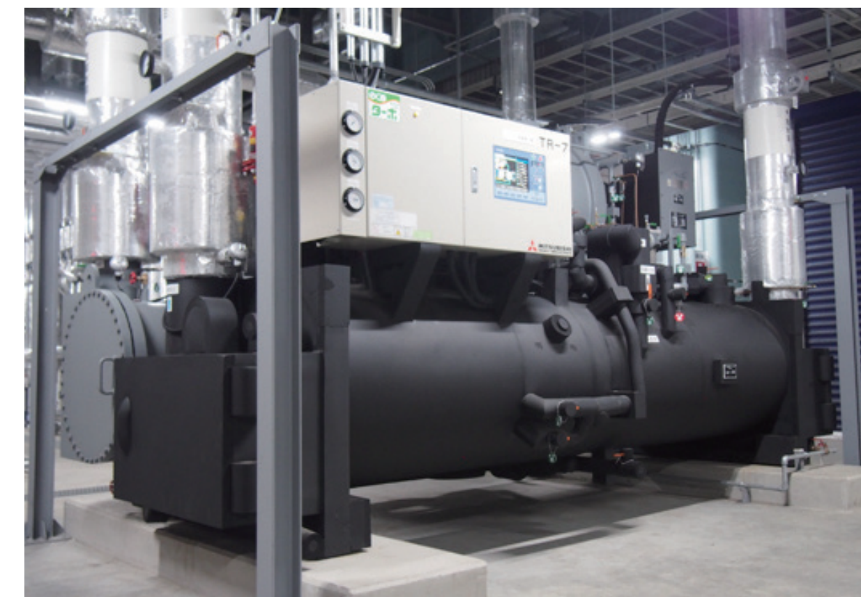
● 熱回収ターボ冷凍機
