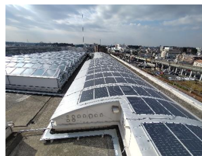
▲太陽光発電設備
