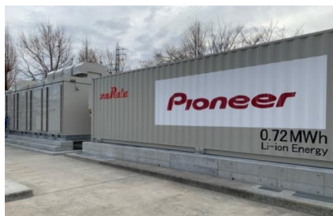
パイオニア・マイクロ・テクノロジー株式会社本社工場様 設置状況
